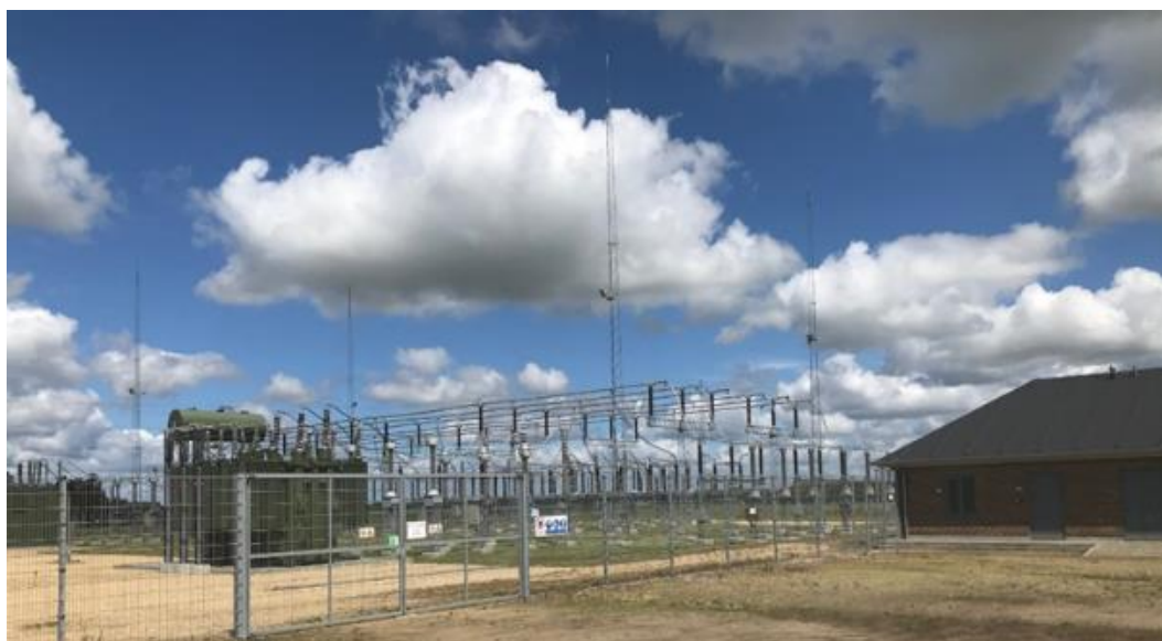
Figur 2.2: Eksempel på transformerstation.
