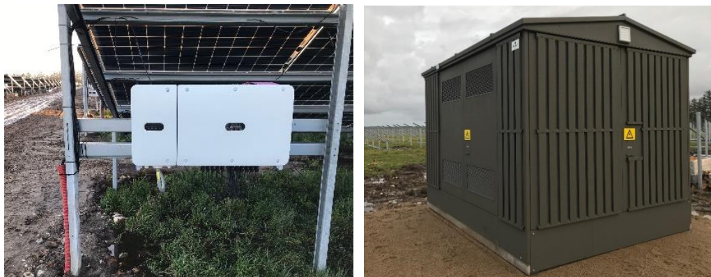
Figur 2.4: De hvide kasser under solcellerne er invertere, som omdanner jævnstrømmen til vekselstrøm (til venstre) og eksempel på teknikbygning, her en typisk fordelingstransformer (til højre).
